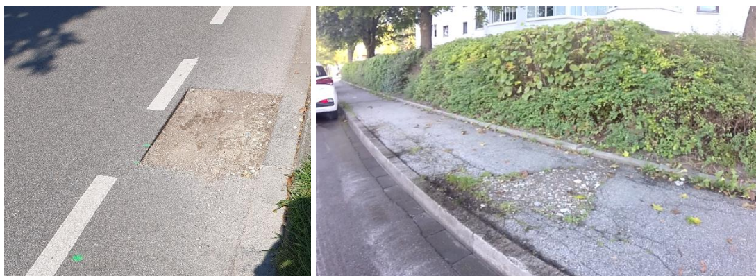
Abbildung 42: Erhaltungszustand Deckschicht (Quelle: Eigene Aufnahme)
